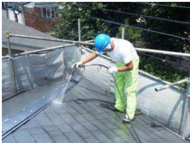
屋根洗浄(埃やカビ・コケを除去) * 高圧・低圧・常圧問わず
